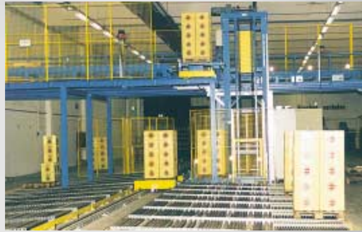
Palettentransport, Anbindung von Fließlager an Kommissionierzone
