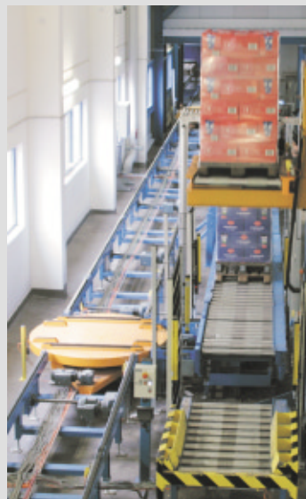
Komplexe Förderer-technik in einer der Verbindungsbrücken.
