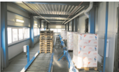
Das Hochregallager ist mit Verbindungsbrücken an die Palettierung angebunden.
